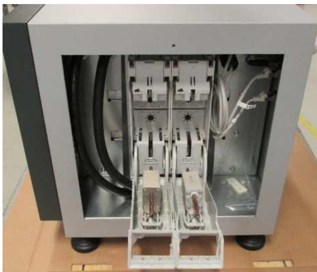
Obrázek 4-13: akumulátorový systém, boční pohled, izolátor napájení vytažený
